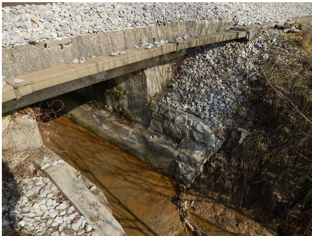
Slika 2: Pogled na drugo stran objekta, ki je precej podobna drugi strani. Pod dnom struge poteka nezavarovan električni vod.
